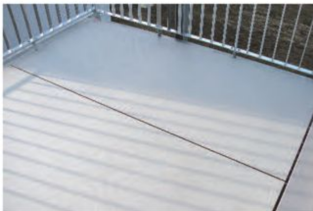
Spadek i styki płyt
